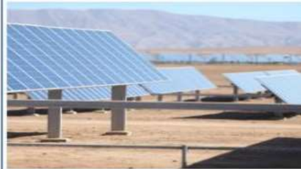
Planta de energía solar Rubí
